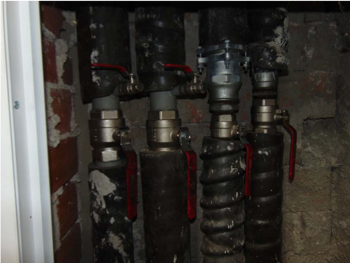
Slika 3 Dvodni cjevovod iz kotlovnice, unutar praonice, ovdje je predviđeno odpajanje sa sustava grijanja kotlovnice I spajanje novoprojektiranog sustava grijanja putem dizalice topline zrak-voda
