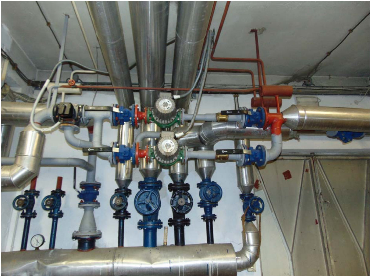
Slika 1. Postojeća kotlovnica unutar susjedne škole s koje se odvaja vrtić
