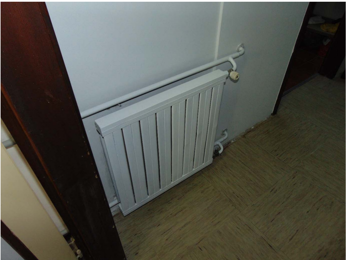
Slika 4 Postojeće ogrjevno tijelo bez termostatskog ventila, sva ogrjevna tijela se zadržavaju, a na ona koja nemaju termostatske ventile intalirati će se termostatski ventili sa termostatskim glavama
